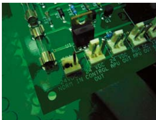
照片(四)拆下第一塊電路板後馬上發現燒燬的端子接腳。
