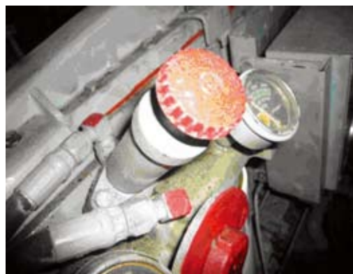
照片(十二)手動燃油注油泵。
