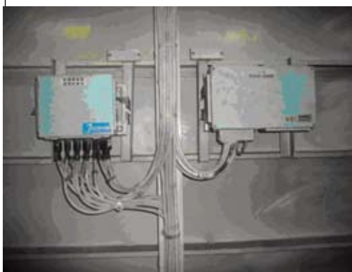
照片(九)舵機房之介面控制箱。
