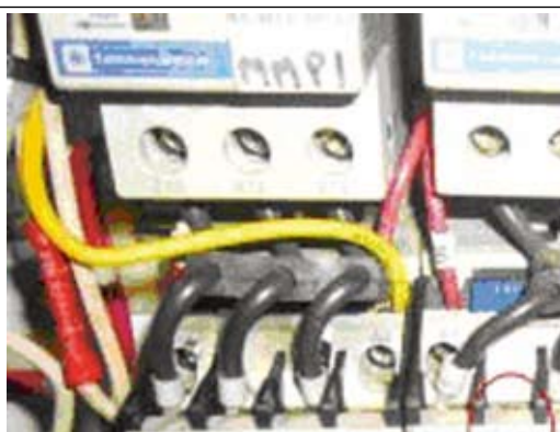
照片(二)真空泵電磁開關欠相之故障接點。
