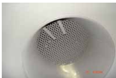
圖6排氣入口網柵清潔前情況
