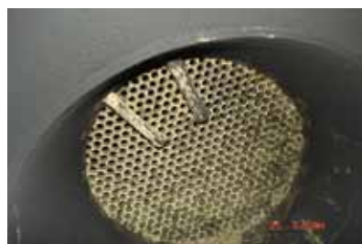
圖7排氣入口網柵清潔後情況
