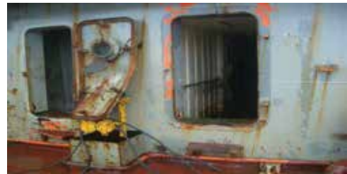
照片一：通往永昌輪主甲板 遭襲毀以及遺失的水密門
