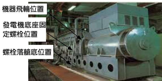
圖2 發電機飛輪底部揀起一斷裂螺栓及底座墊片
