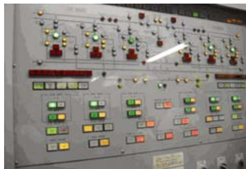
圖16 台達三號鍋爐控制盤及蒸汽系統
