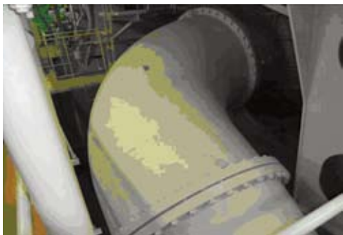
圖13 機艙蒸汽渦輪機冷凝器海水進口
