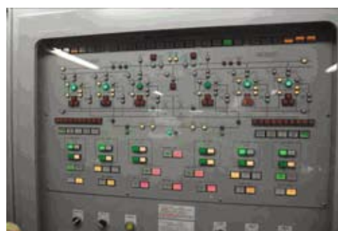
圖10機艙主鍋爐控制台
