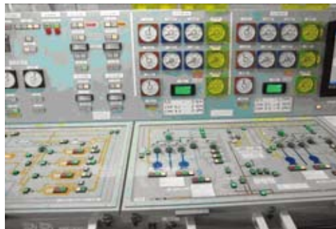
圖8 裝卸貨作業辦公室操控台及儀表
