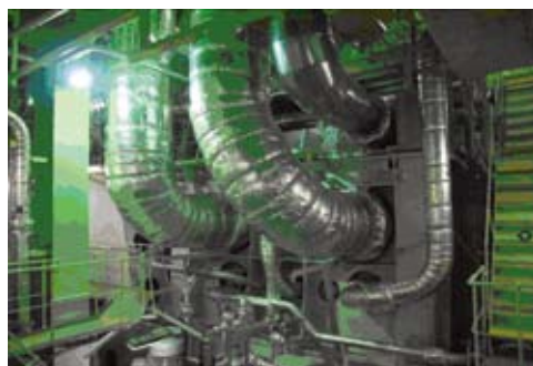
圖12 機艙高壓蒸汽渦輪主機
