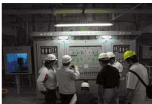
圖9機艙主鍋爐控制台
