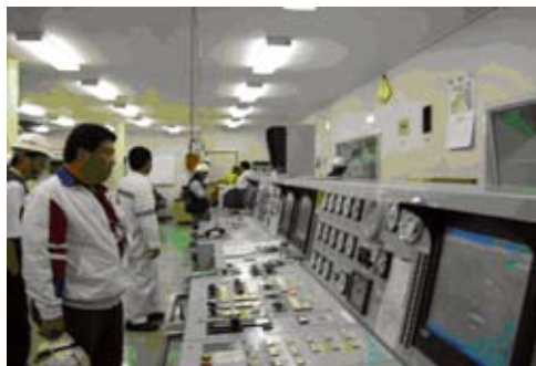
圖15 台達三號機艙控制室
