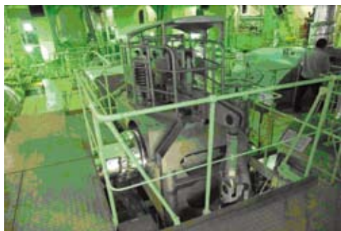
圖11 機艙高壓蒸汽渦輪主機
